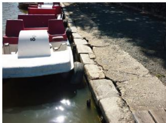
Les vieilles boutisses en grès qui marquent la rive du quai doivent être impérativement conservées et reposées dans le cadre de la rénovation à court terme de cet ouvrage.
